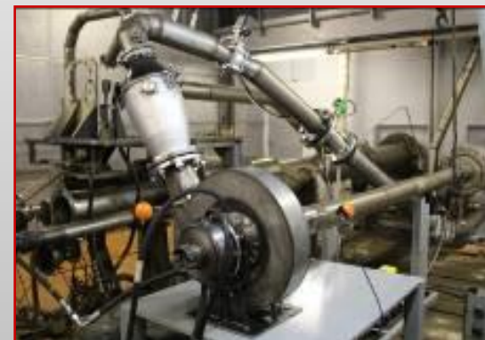
СТЕНД ИСПЫТАНИЙ ТУРБИН
